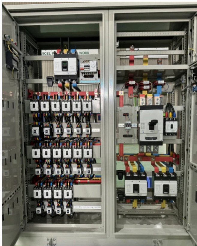
Armoires électriques et câblage électriques
