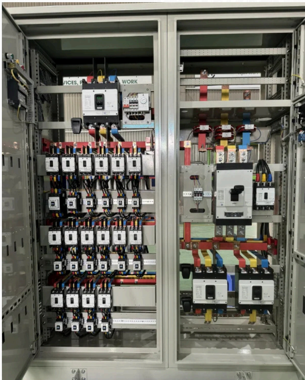
Armoires électriques et câblage électrique
